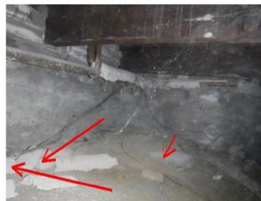
restanten in kruipruimte
