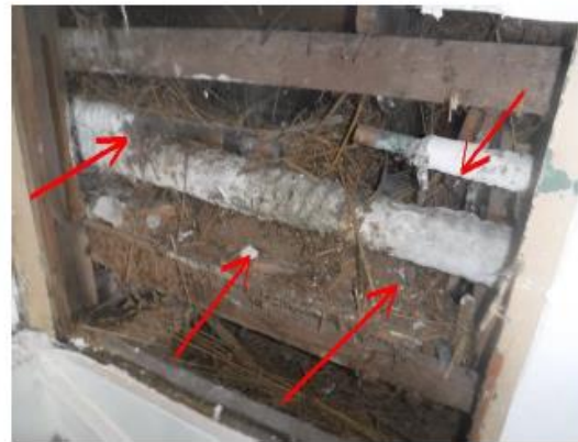
zwaar beschadigd leidingsisolatie achter knieschot
