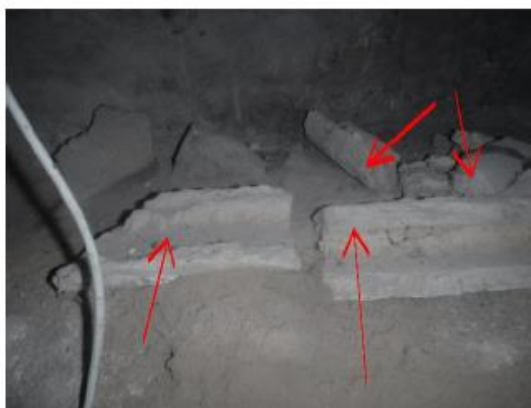
restanten in kruipruimte
