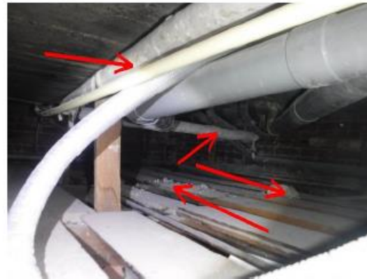
leidingsisolatie sterk beschadigd.
